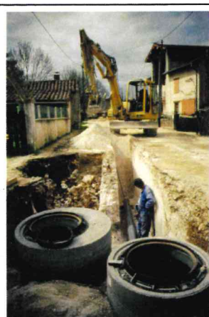
En 2004, deux tranchées : eau potable et eaux usées (plus une troisième pour les eaux pluviales !)
