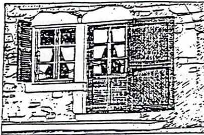
la fenêtre jumelée avec une porte, un jambage commun en pierre verticale.
